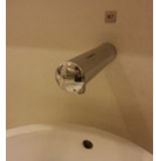
圖 107 節水設備 (來源：啟勝管理服務有限公司)
