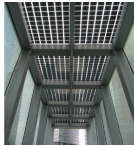
圖 114 安裝在九龍灣零碳天地的光伏系統
