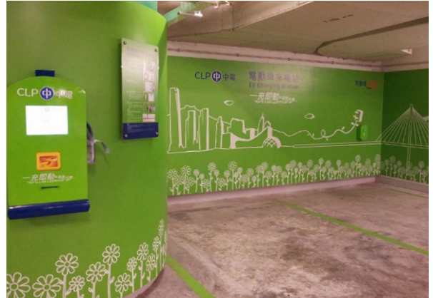
圖 61 電動車輛充電設施 (來源: 太古地產有限公司)
