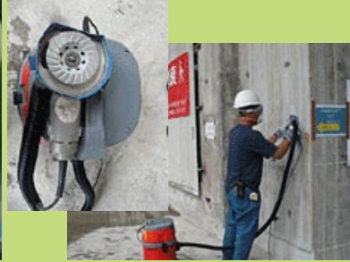
圖 136 連接吸塵機的研磨機 (來源：環境保護署)
